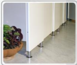
اختلاف ارتفاع پارتیشن با کف جهت شستشو
